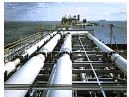
Figura 4 – Aplicação do aço inoxidável em tubulação de indústria petroquímica.
